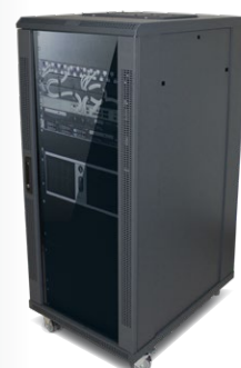
▼ Baie 27U (Assemblée et cablée)
