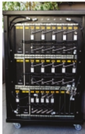
Cabecera instalada en Hotel Nelas Park (Nelas-Viseu)
